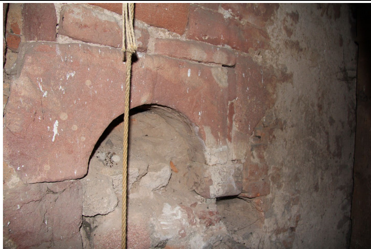
Zazděné sdužené románské okno západní strany 3. patra věže v pohledu od západu. Foto: Jaroslav Skopec 2019.
