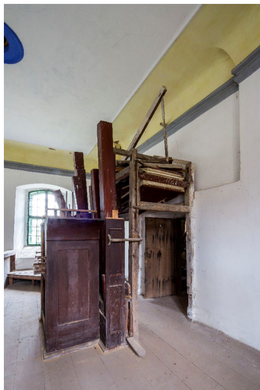
Západní stěna lodi na úrovni krucht v pohledu od severu. Vpravo se nachází vstup do 1. patra věže a ním ústupek ve zdivu. Foto: Marta Pavlíková 2019.
